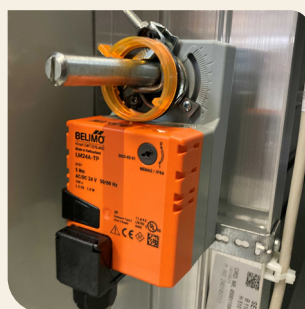
Figuur 3. Servomotor t.b.v. buitenluchtkep
